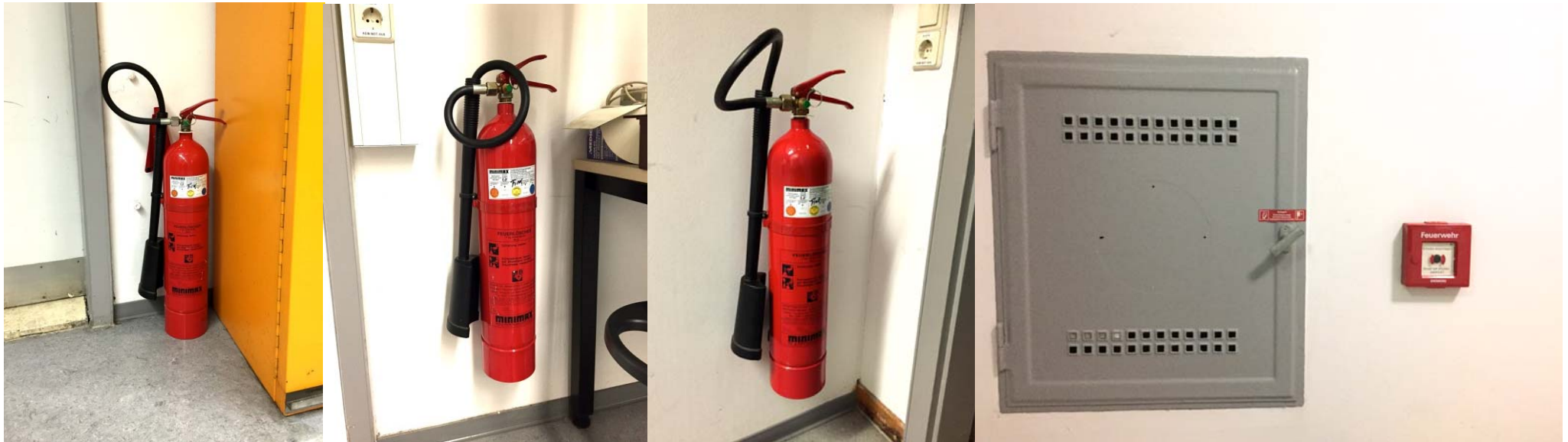
CO 2 -Feuerlöscher im Labor
